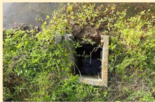
水田給水栓付近での繁茂
