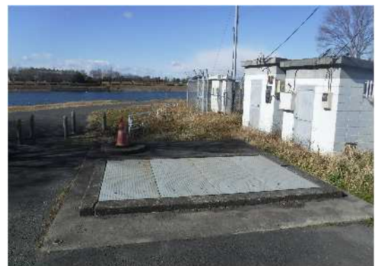
権現堂調整池の雨水放流ゲート
