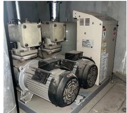
老朽化した定圧給水ユニット
