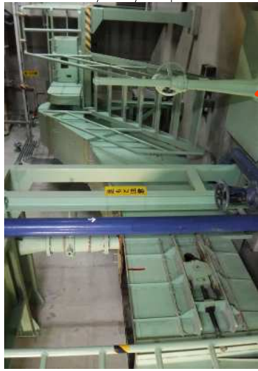
R4~5 沈砂洗浄機
