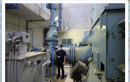
川妻機場の内部
