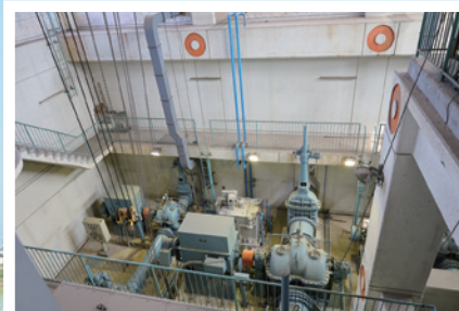
川妻機場の内部
