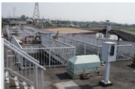
五霞町環境浄化センター
