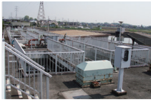
五霞町環境浄化センター
