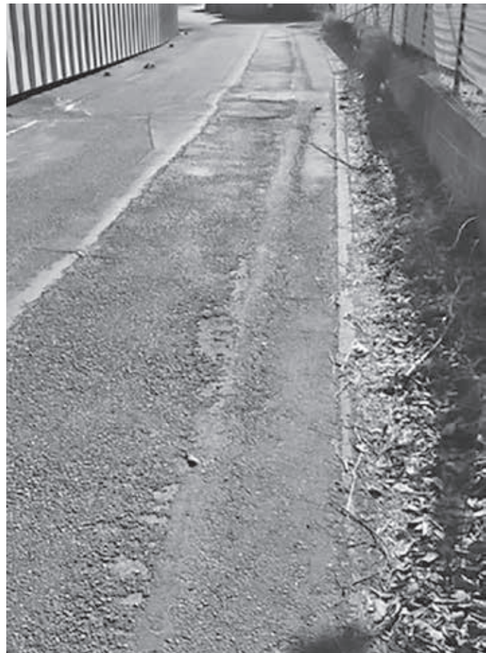
補修されていない町道
