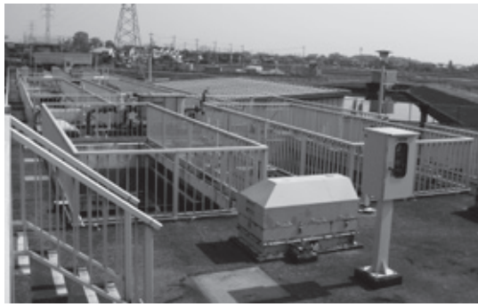
五霞町環境浄化センター
