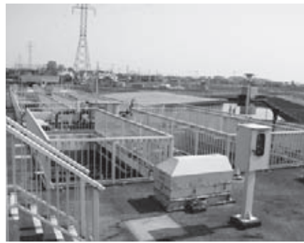
五霞町環境浄化センター
