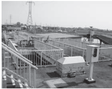
五霞町環境浄化センター
