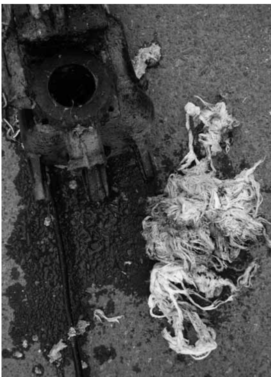
ポンプに絡まっていた異物
