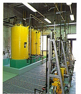
薬品注入設備（次亜塩）
