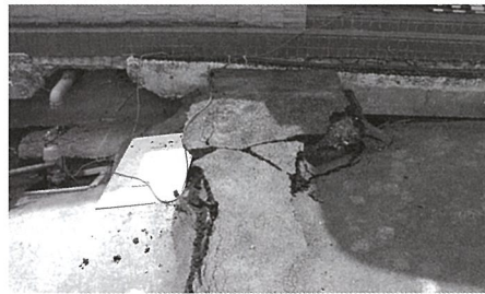
川妻浄水場の地盤沈下状況
