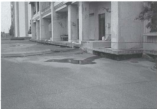
地盤沈下による被害状況
