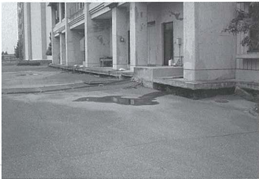
地盤沈下による被害状況
