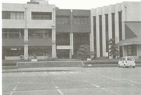
耐震補強が求められる中央公民館
