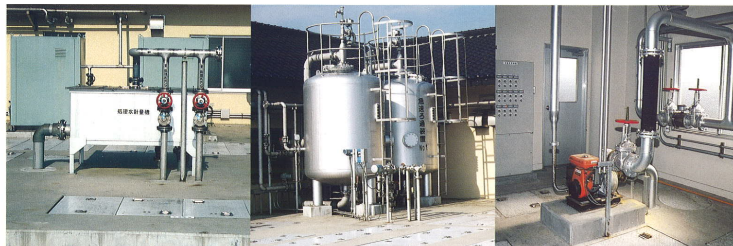
処理水計量槽
